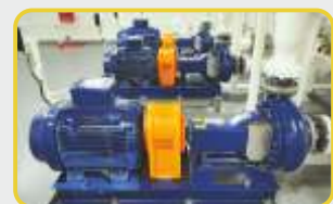
水和污水泵站
