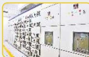
机器电气面板
